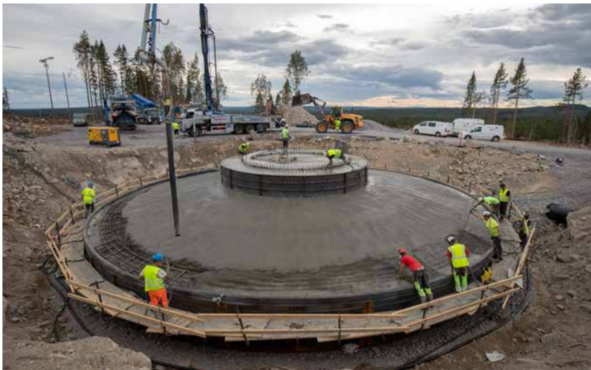
Figur 8. Gjutning av ett gravitationsfundament inom Vindpark Valhalla i Bollnäs- och Ockelbo kommuner (foto: Joakim Lagercrantz).
