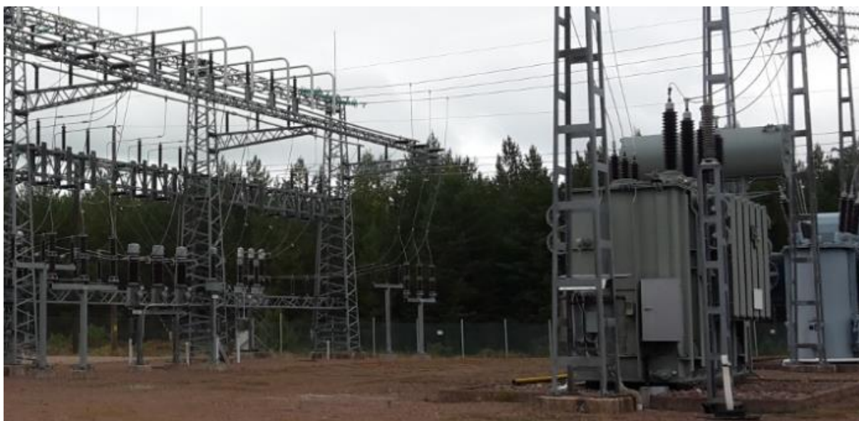
Figur 9. Exempel på ställverk för anslutning av solparken till överliggande elnätet (Bildkälla: www.vattenfall.com).
