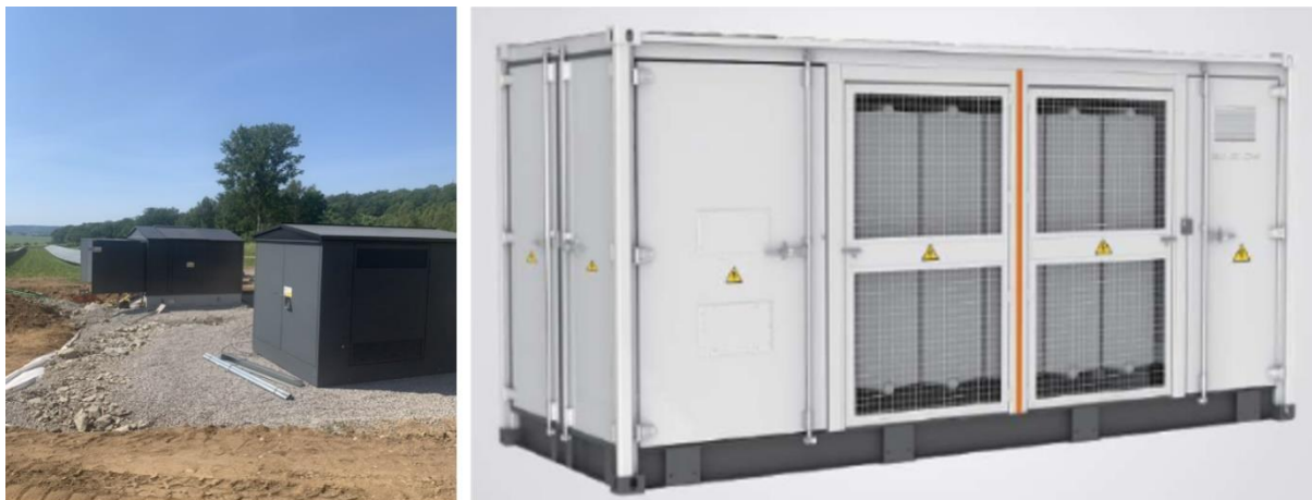
Figur 7 och 8. Vänster: exempel på utformning av transformatorstation inom anläggningen (foto: Magnus Fast OX2). Höger: exempel på utformning av mottagningsstation inom anläggningen (foto: OX2).
