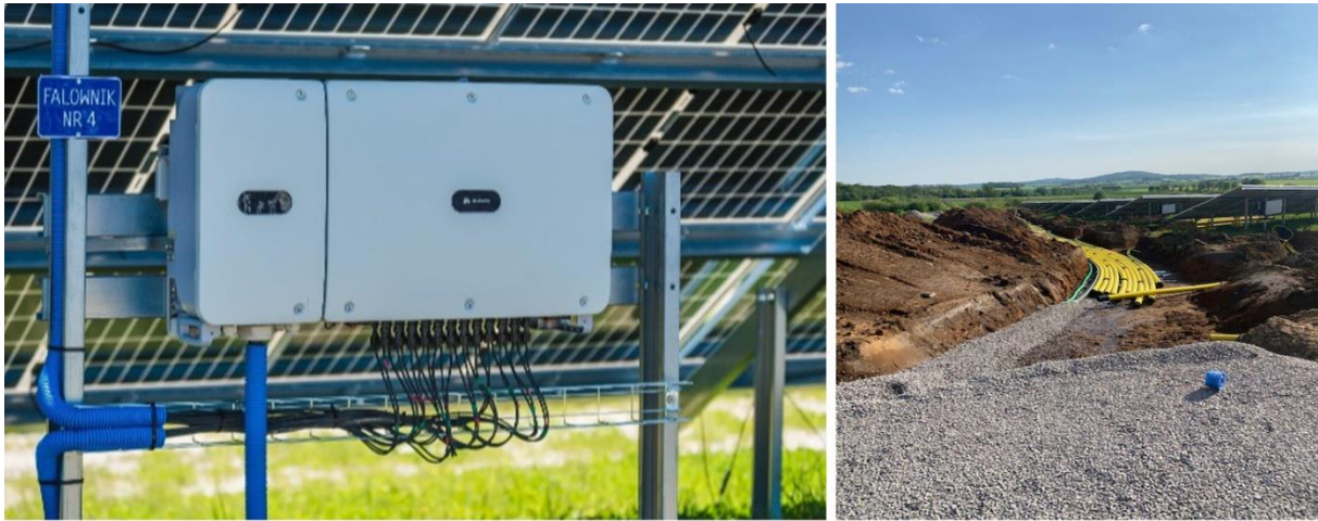
Figur 12. Vänster: växelriktare som monterats på markställning (bildkälla: www.ske-solar.com). Höger: exempel på kabelschakt inom anläggningen (foto: Magnus Fast, OX2).
