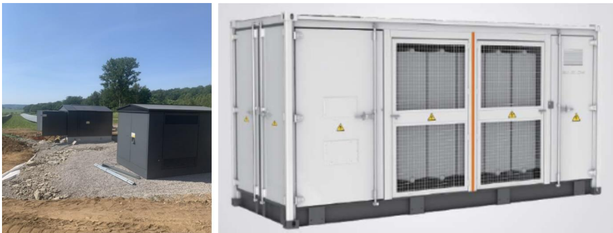
Figur 13. Vänster: exempel på utformning av transformatorstation inom anläggningen (foto: Magnus Fast OX2). Höger: exempel på utformning av mottagningsstation inom anläggningen (foto: OX2).
