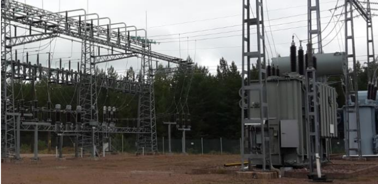
Figur 9. Exempel på ställverk för anslutning av solcellsparken till elnätet. Bildkälla: www.vattenfall.com
