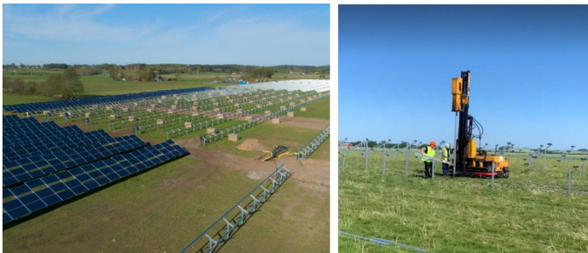
Figur 4 och 5. Vänster: exempel på montage av solpaneler på markställningar. Anläggningen är Svea Solars solenergianläggning i Sjöbo (Bildkälla: Ny Teknik). Höger: Pålning av balkar med pålningsmaskin (foto: Magnus Fast, OX2).
