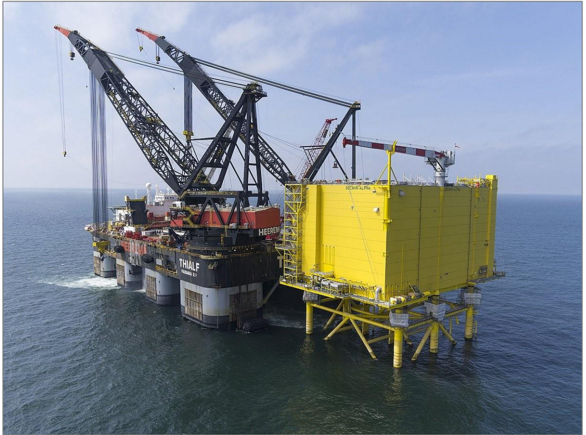
Kuva 2-7. HVDC DolWin Alpha, esimerkki asemasta, jossa on ristikkoperustus. Nosturialuksen nostokapasiteetti on noin 22 000 tonnia. Lähde: www.overdick-offshore.com .
